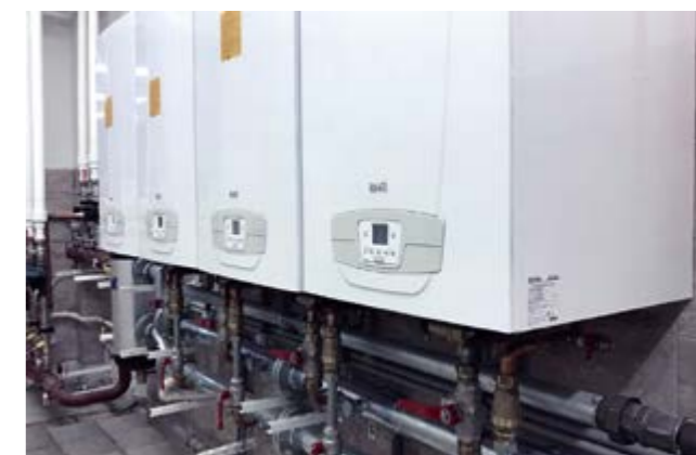
Общежитие, г. Усть-Луга Общая мощность котельной - 300 кВт
