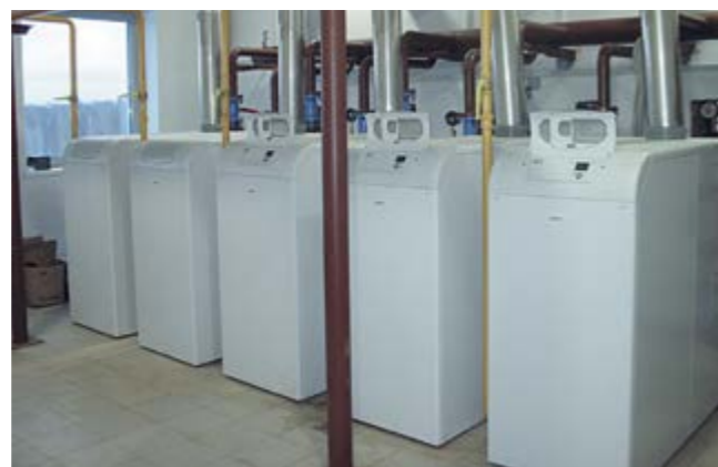
Кинотеатр, г. Йошка-Ола Общая мощность - 1,6 МВт
