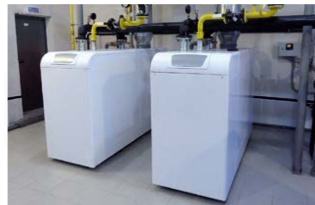
ТЦ «Крона», г. Чебоксары Общая мощность котельной - 1 МВт
