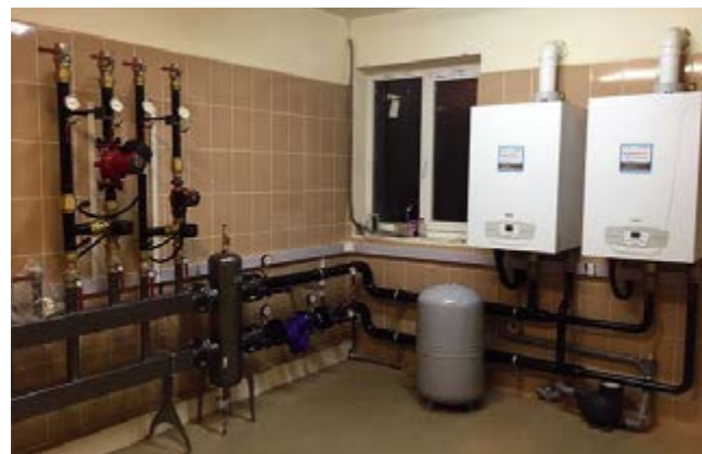
Автосервис, г. Москва Общая мощность котельной - 300 кВт
