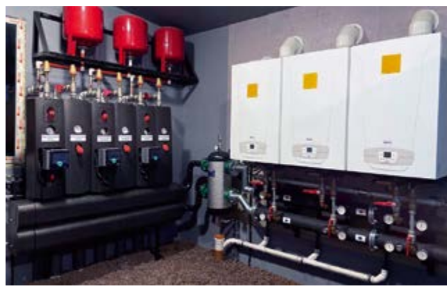
Гостиничный комплекс, г. Архыз Общая мощность котельной - 300 кВт
